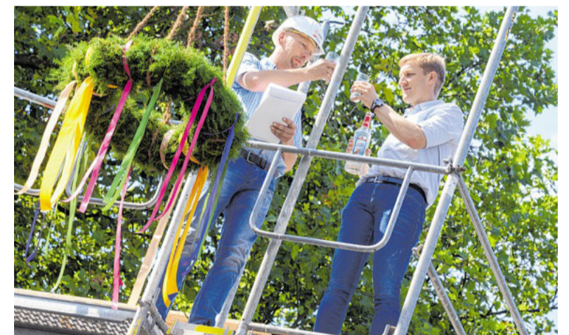
Bauführer Martin Martmann (li.) und Einrichtungsleiter Alexander Escher beim Richtspruch oben auf dem zweistöckigen Neubau in der Boy. FOTO: HEINRICH JUNG
